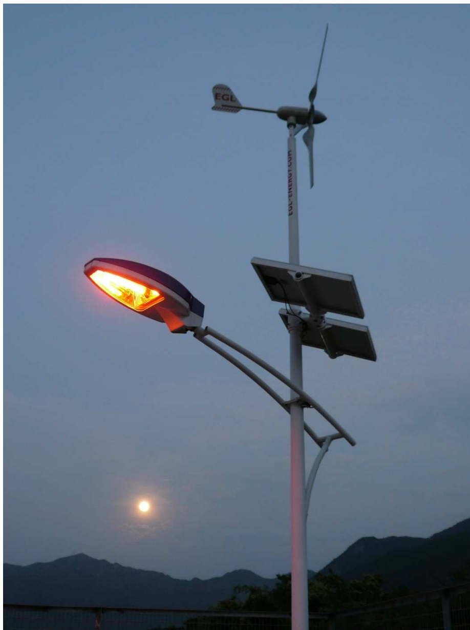
Fot. 1, Pracująca lampa hybrydowa
